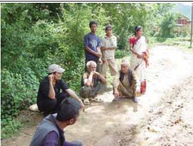
休憩中の建設作業員。後ろのサリー姿の女性は、この村の SHP in Charge (保健員) 着々と完成に近づく新しい簡易保健所を見て、にっこり。
