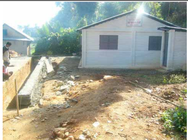
土を掘り出し、土砂が崩れないよう壁を設置した。これで、既存の事務所も、簡易保健所も安全。
