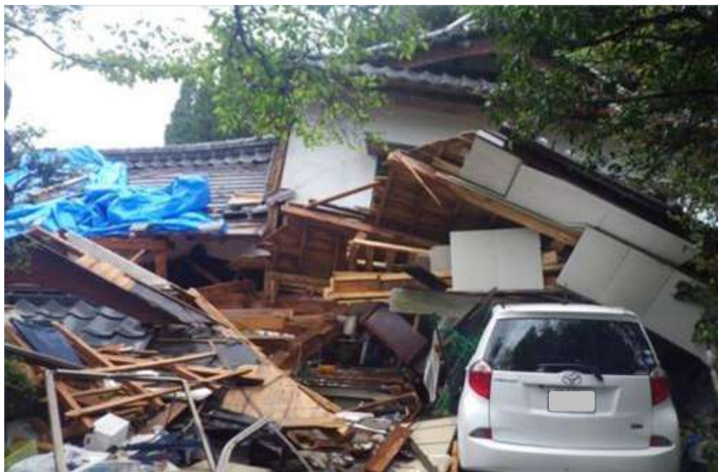
発災直後の住宅被害
