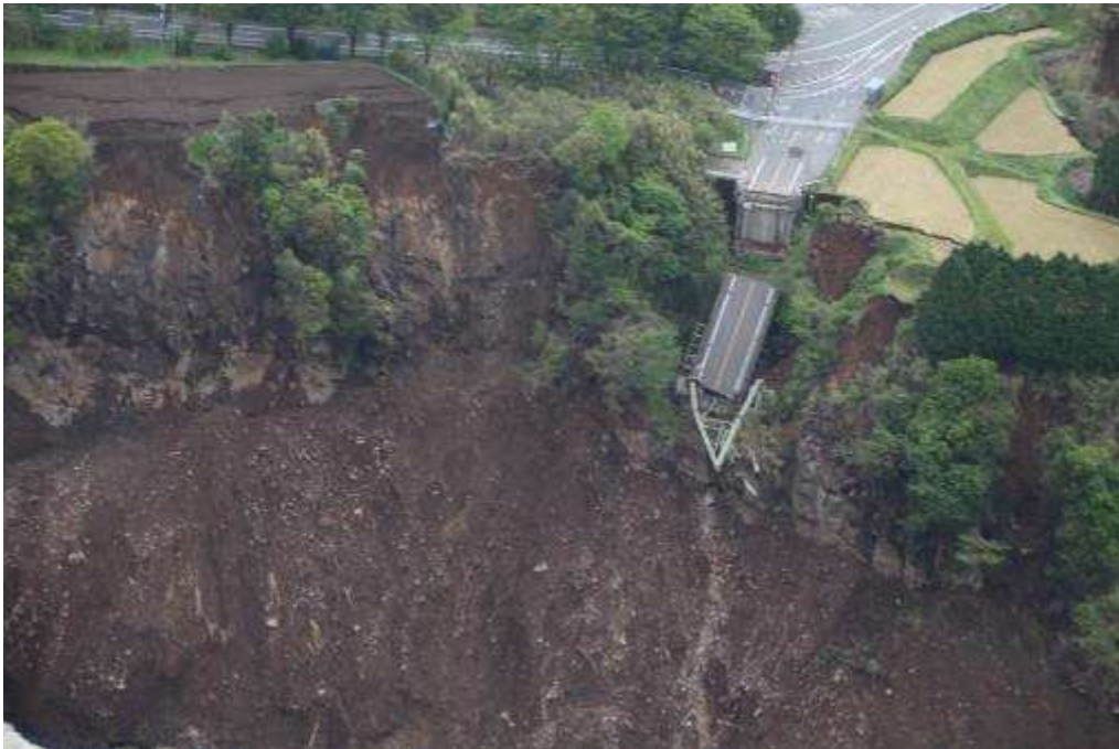
崩落した国道 57 号の阿蘇大橋
