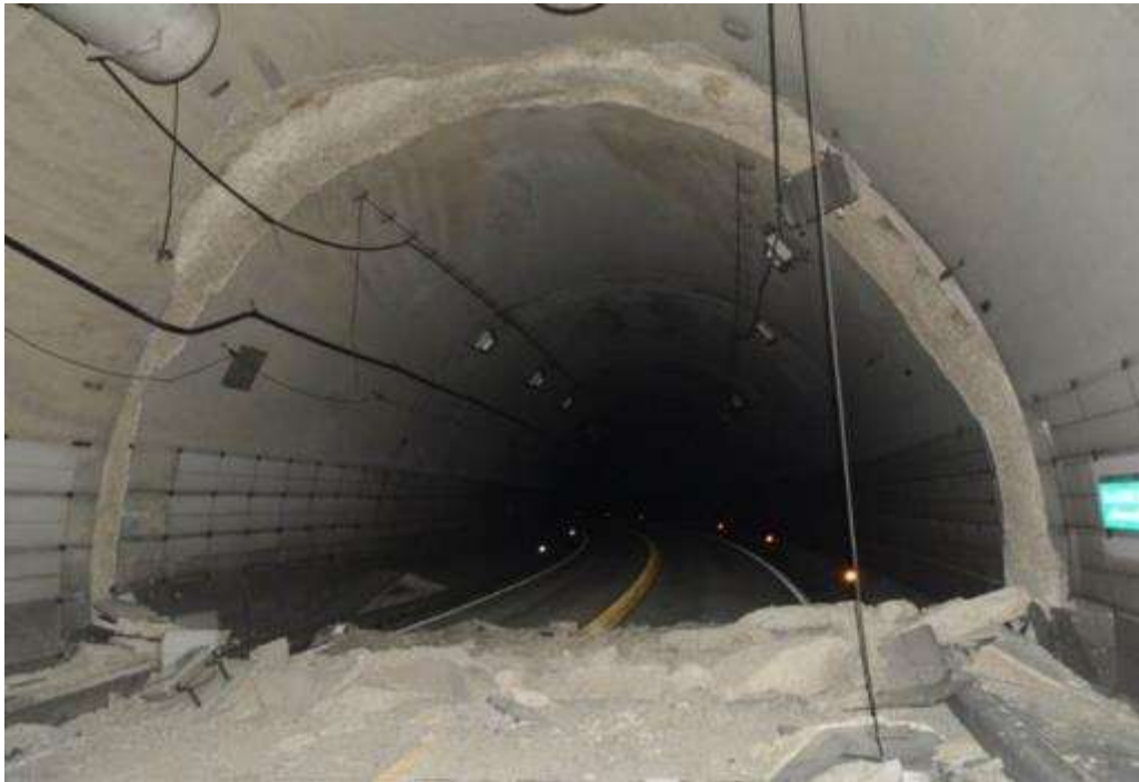
被災により封鎖された県道 28 号線の俵山トンネル
